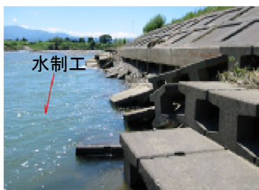
護岸の破損状況
