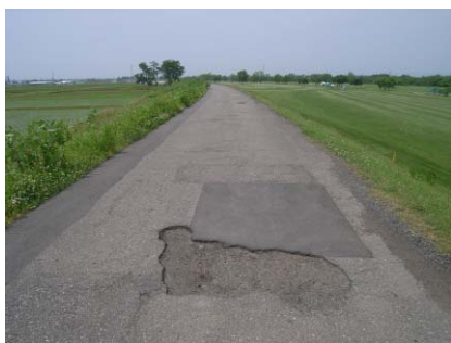
堤防の上面舗装補修前の状況
