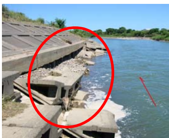
出水による護岸の崩落
