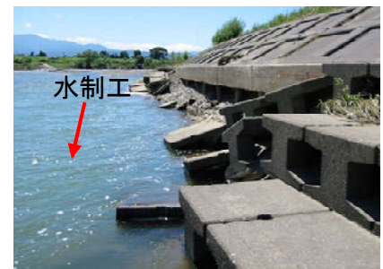
出水における護岸の被災状況
