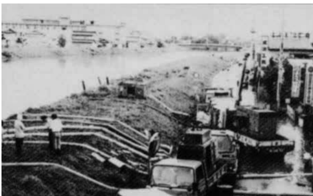
内川内水排除の状況 [鶴岡市鳥居町地区] (昭和 62 年 8 月洪水)
