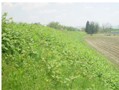
有害な植生(イタドリ等)の繁茂
