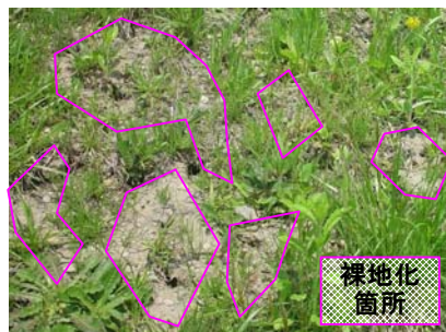
堤防法面の裸地化
