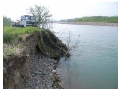
河岸崩壊の状況
