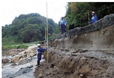
R1.10台風19号被害(福島県田村郡三春町) TEC-FORCE活動状況(被災状況調査)
