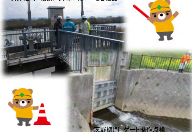
茨野樋門 機械に異常が無いことを確認
