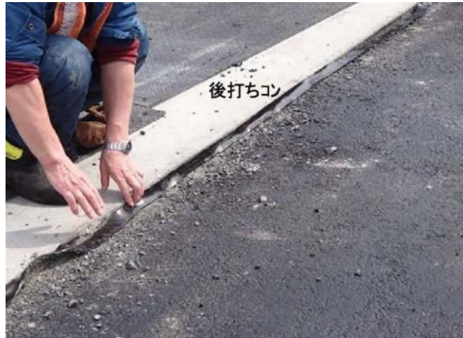
写真-1 ゴミや小石が溜まっているため成型目地材がヨレて正しく設置出来ない
