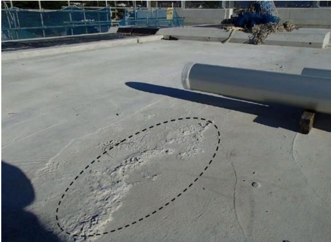
写真-1 床版コンクリートのレイタンスの除去忘れ
