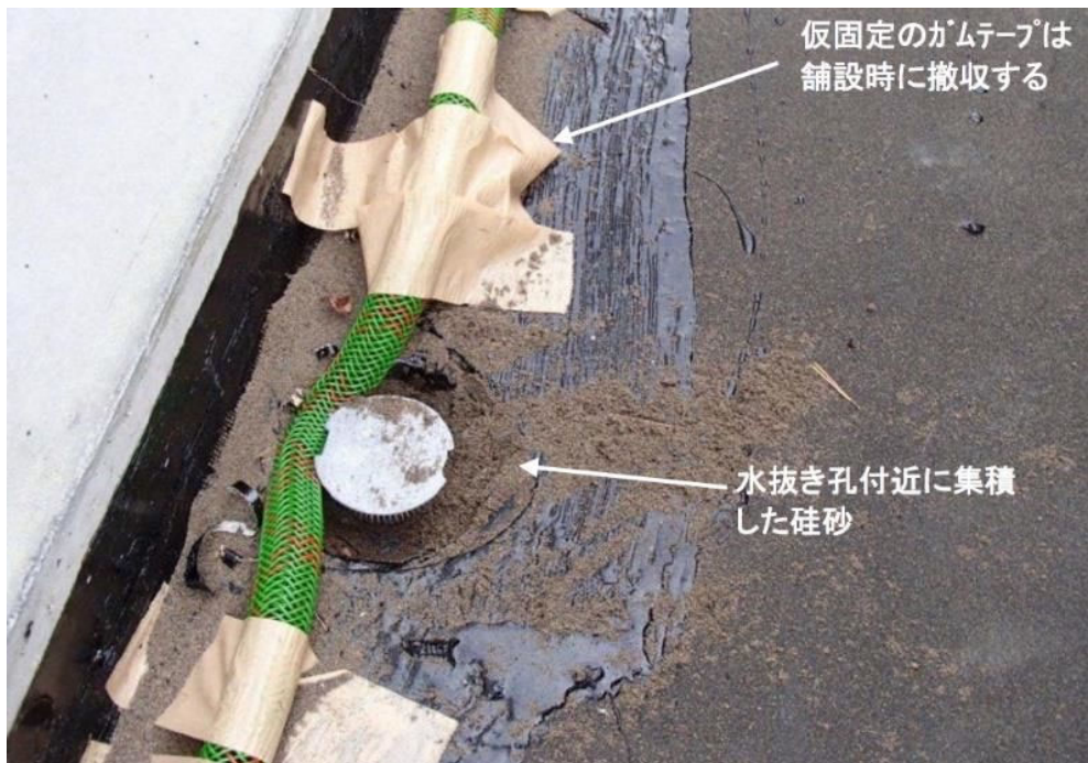
写真-1 防水シートに付随した砂が飛散し、水抜き孔付近に集積した例 (対応例: 防水シートの設置から基層工の舗設までのあき期間を短くする)
