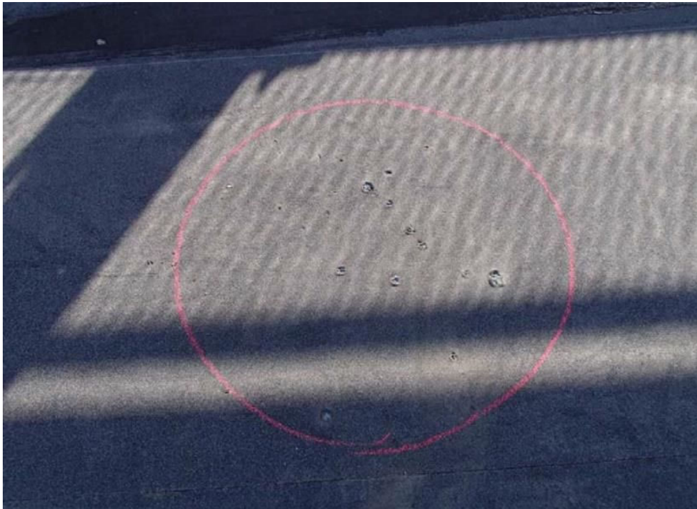
写真-1 常温貼りで複数孔の損傷例
