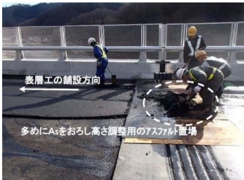
写真-1 伸縮装置付近:後打ちコンの高さに合わせるための調整用アスファルト
