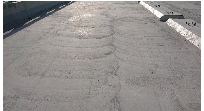
写真-3 均しの跡が残ってしまった事例
