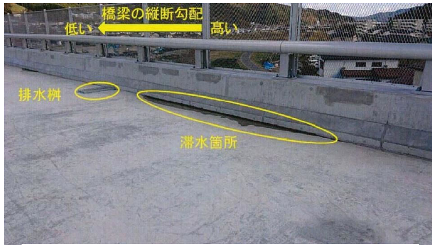
写真-1 平坦性不良のため滞水箇所が生じた事例
