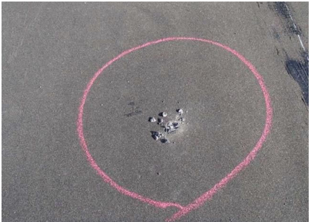
写真-2 流し貼りでのシート損傷例(孔が開く)
