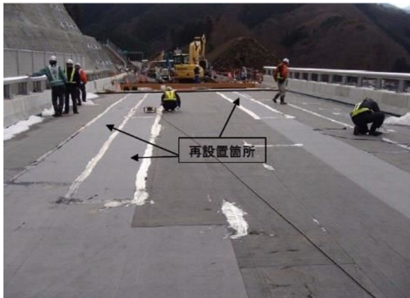
参考写真-4 空気泡の発生箇所数が多かったり、強風で飛ばされたりした箇所は防水シートを再設置する(継目にアスファルトを塗布:強風飛散防止対策)
