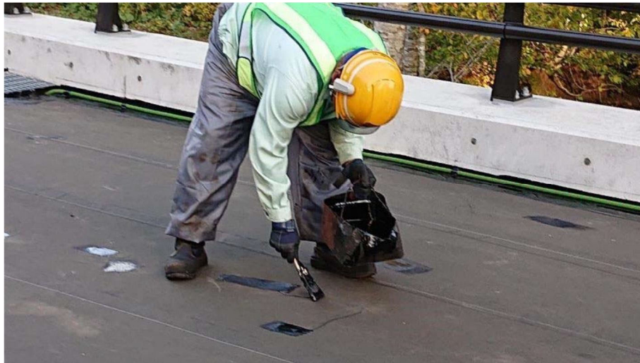
参考写真-3 空気泡発生箇所の孔開け処理後、シートの孔開け箇所にアスファルトを上塗りする
