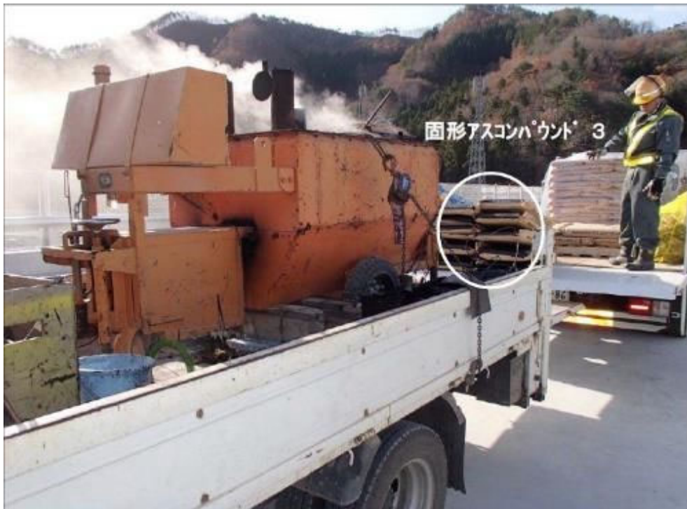
写真-1 固形アスコンパウンド(アスファルト)の溶融釜
