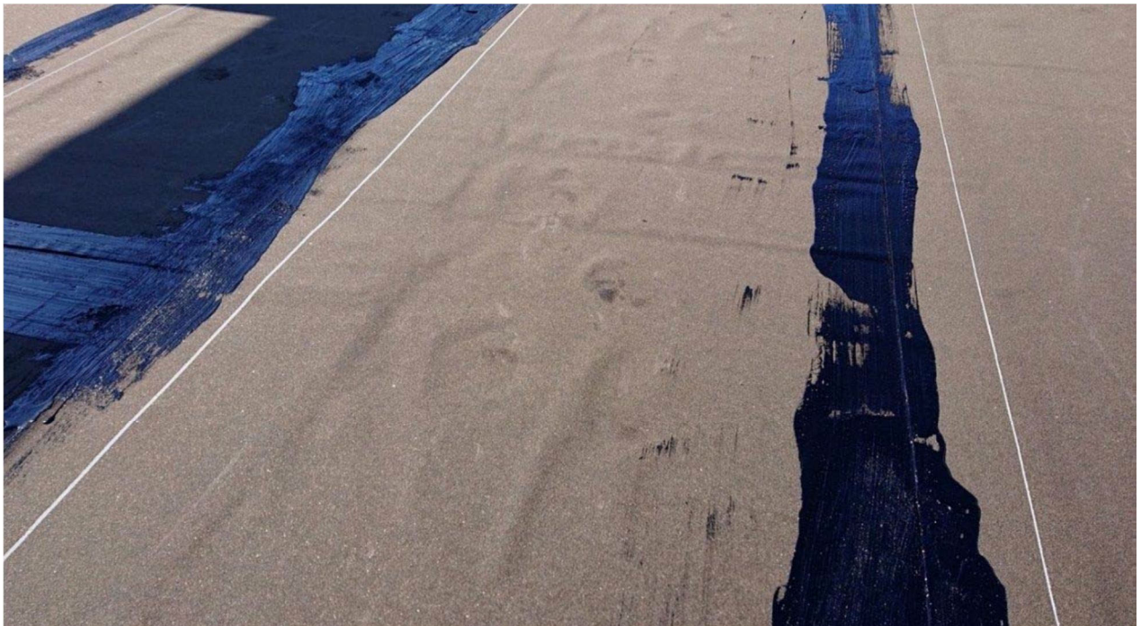
写真-2 防水シート貼り付け後(凹凸若干あるが空気泡ではない)
