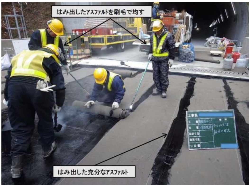
写真-1 防水シート継目を刷毛により、はみ出したアスファルトを均す状況
