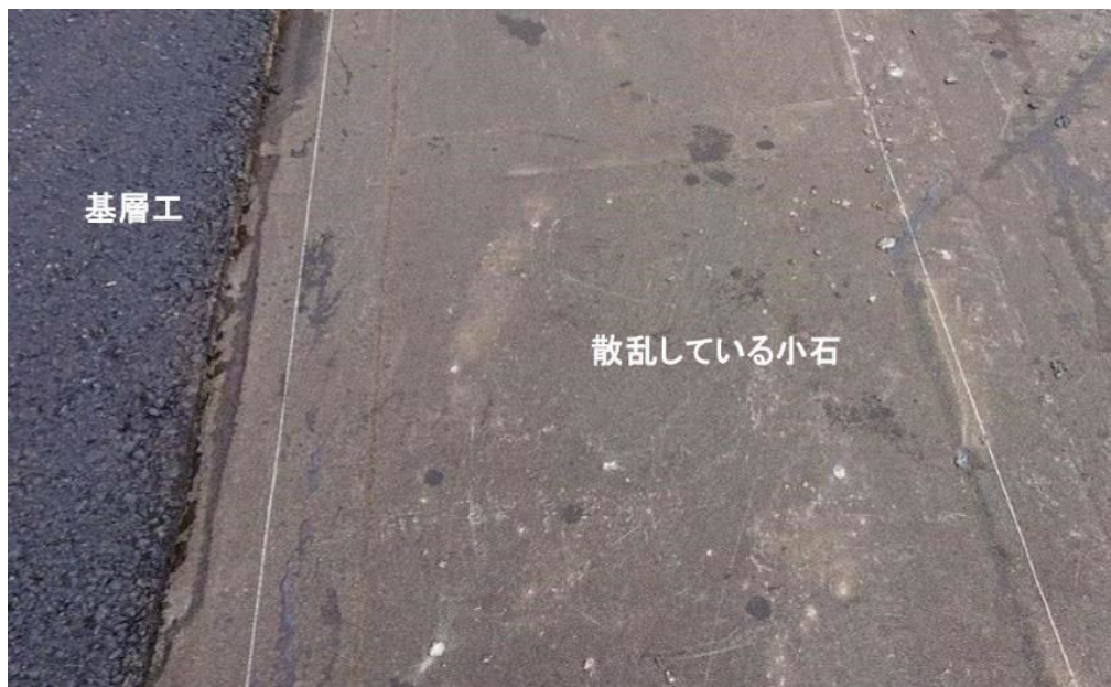
写真-1 複数孔の損傷が発生
