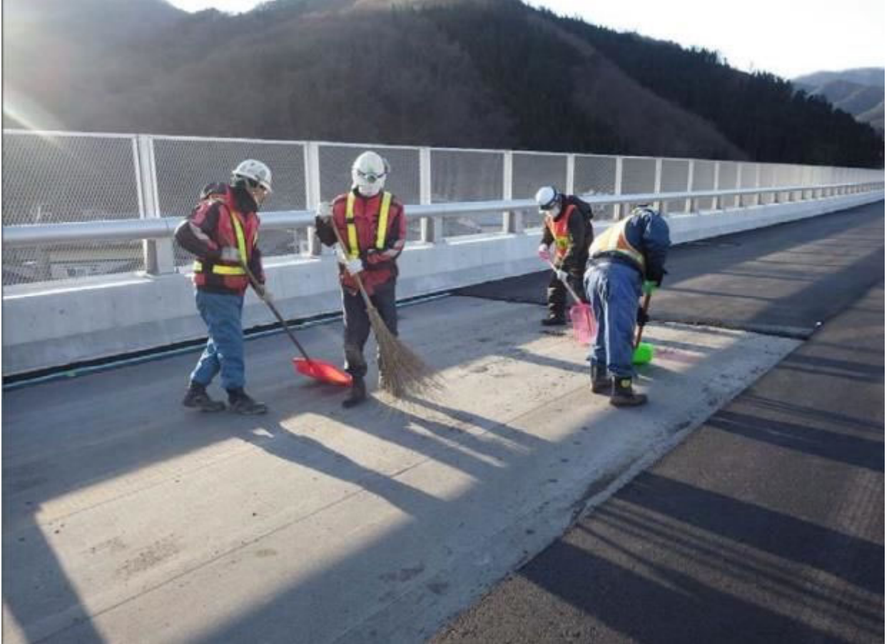
写真-1 当日の舗設終了後:防水シート上の残存アスファルトの除去作業
