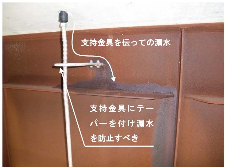
写真2. 4. 6 支持金具経由の漏水痕
