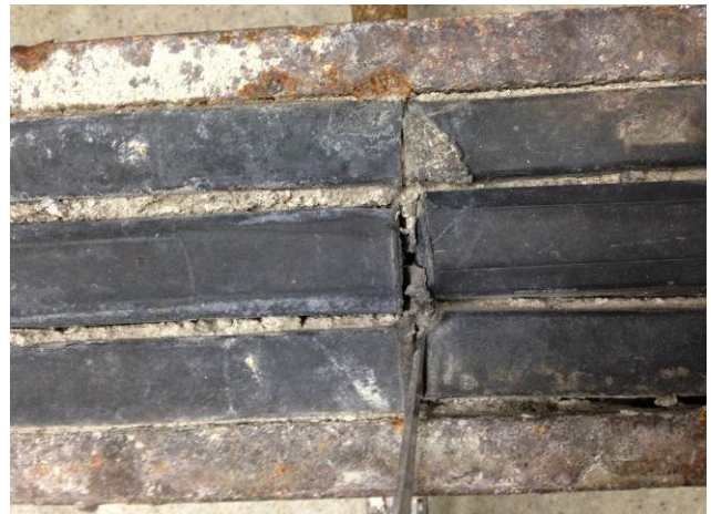
写真 2. 1. 4 止水材接合部の不具合例 (隙間が生じている事例)
