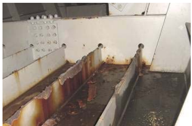
写真 2. 3. 2 箱桁内滞水による腐食 (排水管からの漏水により箱桁の下フランジに腐食が発生)
