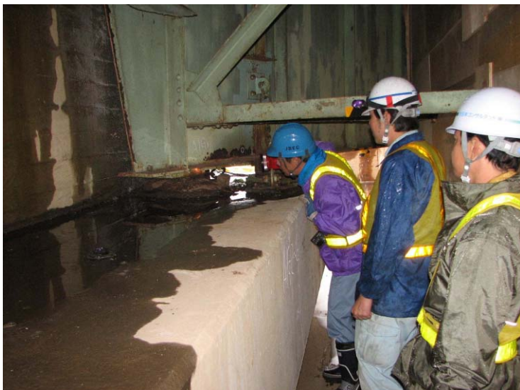
写真 2. 6. 1 橋座の滞水状況
