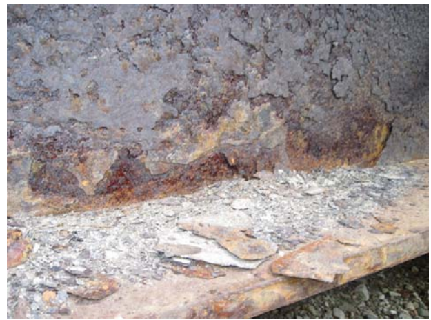
写真 1. 2 耐候性鋼材の層状さびの事例 (凍結抑制剤を含む橋面水の影響で下フランジに発生した層状さび)
