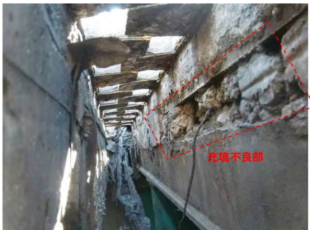
写真2. 1. 5 後打ちコンクリートの充填不良
