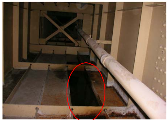
写真 2. 3. 1 箱桁内の滞水状況 (排水管からの漏水により箱桁内に滞水)
