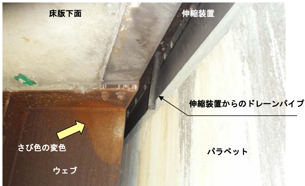
写真 2. 4. 12 伸縮装置からのドレンプайプの影響で桁端部の錆の色が異なっている耐候性鋼材を使用した橋梁の事例（悪い事例）
