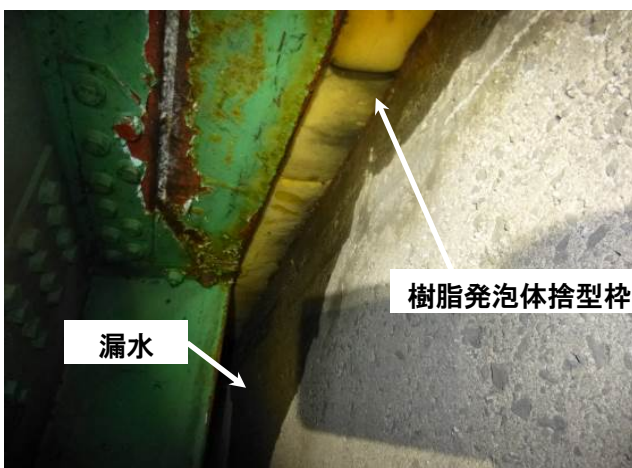
写真2. 1. 7 樹脂発泡体捨て型枠による施工（漏水が位置の特定など点検困難）
