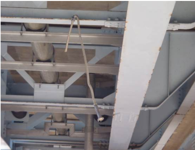
写真2.4.9 スラブドレンのはずれ
