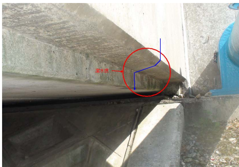
写真2. 2. 1 プレテン床版橋の地覆下部の水切り (主桁への漏水後が見られる)
