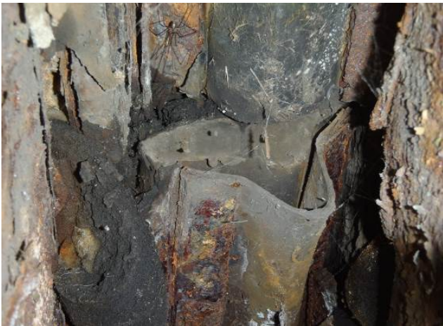
写真 2. 1. 3 止水材接合部の不具合例 (漏水の起点となり脱落が生じたもの)
