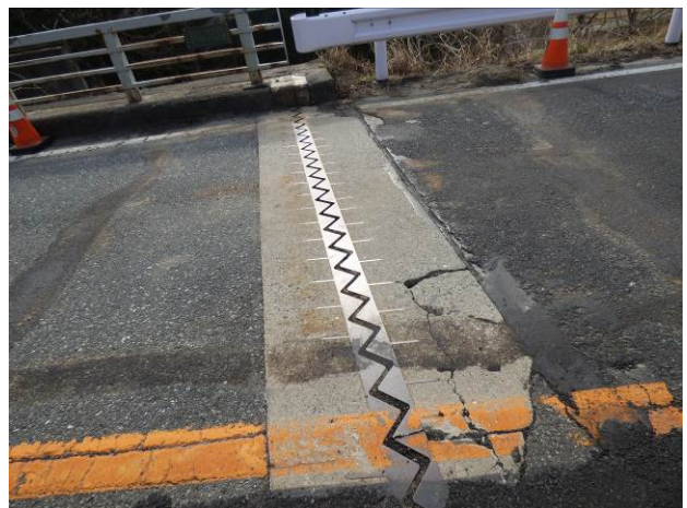
写真2. 1. 6 後打ちコンクリートの陥没（車両の走行により浮き沈みも生じている）
