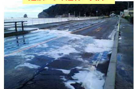
越波により通行に支障
