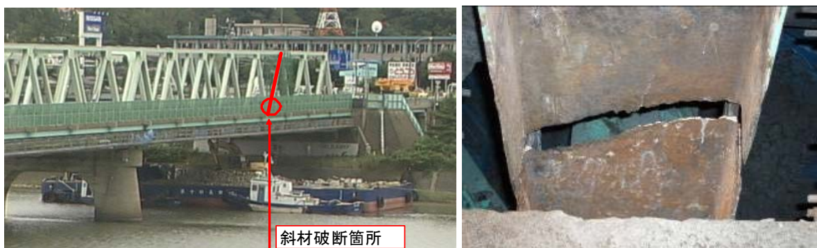
図 36 本荘大橋斜材破断
