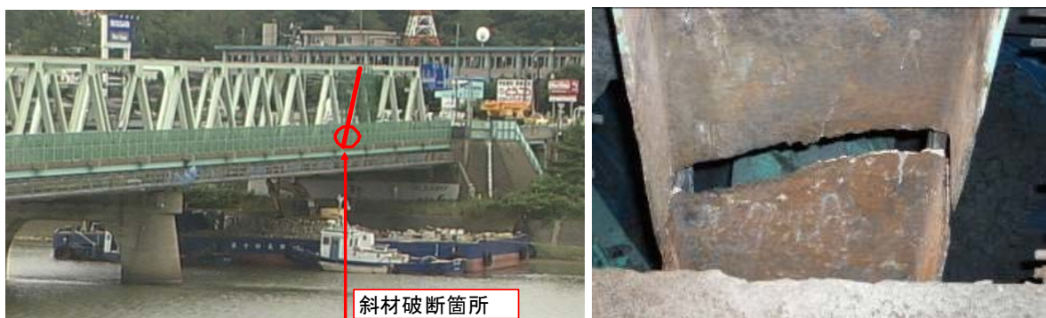
図 36 本荘大橋斜材破断
