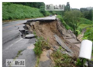
▼R4.8豪雨における被災状況
