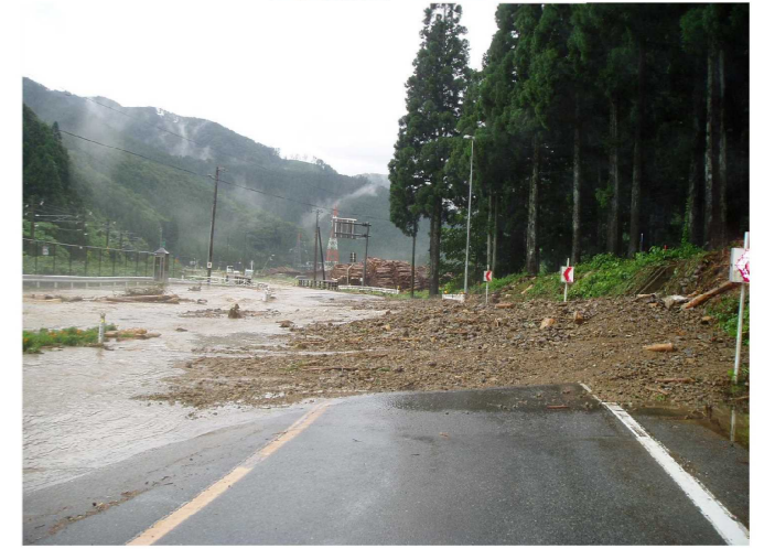
▼法面崩落 H22.7.30
