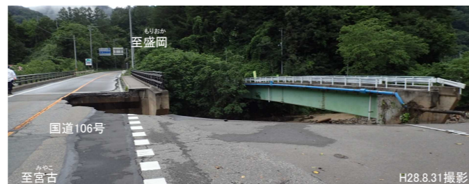
写真① 平成28年 台風第10号災害の被災状況
