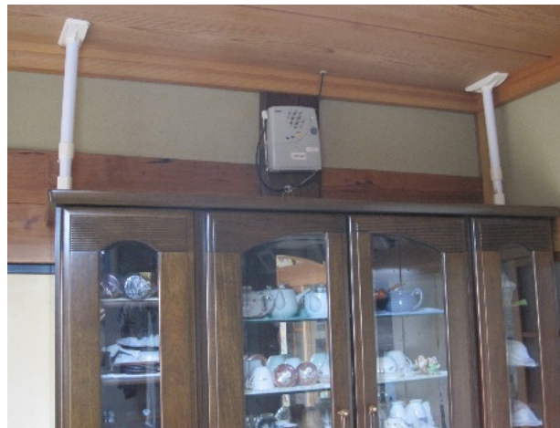
防災無線子機設置状況（一般家庭）
