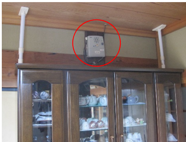
防災無線子機設置状況(一般家庭)
