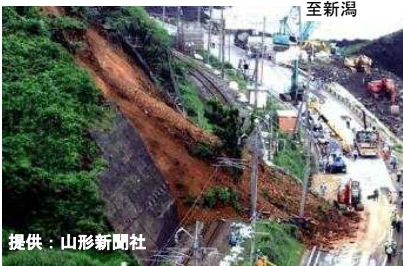
図1 法面崩壊(鶴岡市小岩川地区)
