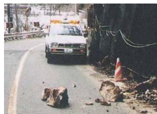
図1 落石発生状況
