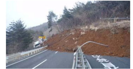
写真② 国道4号伏拝地区の土砂崩落状況(H23.3.11)
