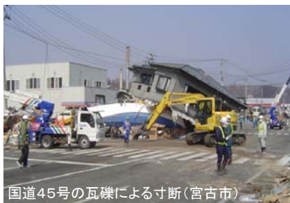
図2 寸断された国道45号
