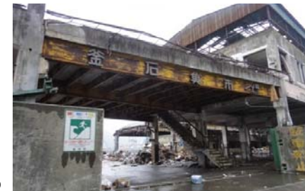
図4 津波被害を受けた釜石魚市場
