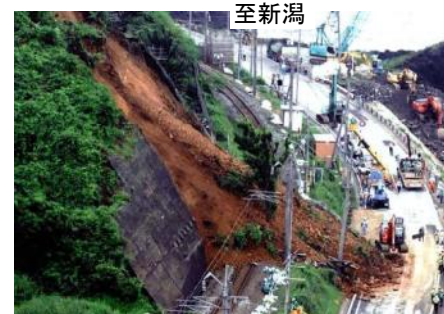
法面崩壊(鶴岡市小岩川地区)
