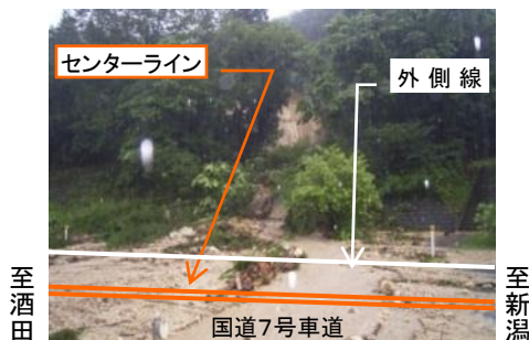
土砂災害(村上市大沢地区)
