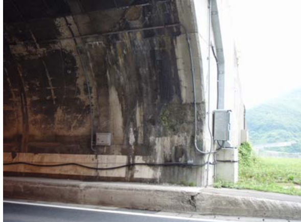
コンクリートのひび割れ
