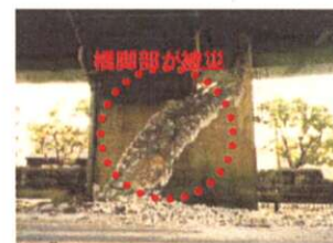
兵庫県南部地震(震度7) (神戸市東灘区)
