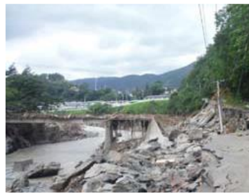
▲平成 28 年台風 10 号(岩手県岩泉町)
