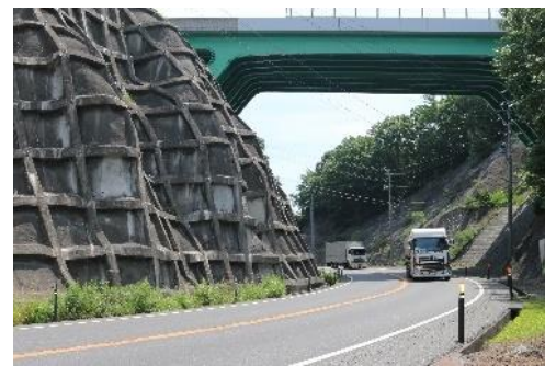
▲国道49号の線形不良箇所
