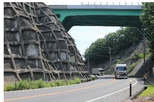
▲国道49号の線形不良箇所
