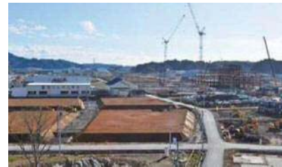
鹿折地区(～H29) 南気仙沼地区(～H27)
