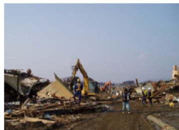
① 国道45号の被災状況
