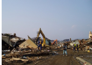
① 国道45号の被災状況
