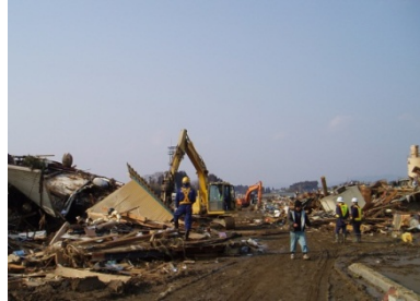
① 国道45号の被災状況
