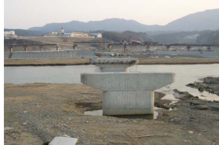
② 津波で落橋した国道45号小泉大橋
