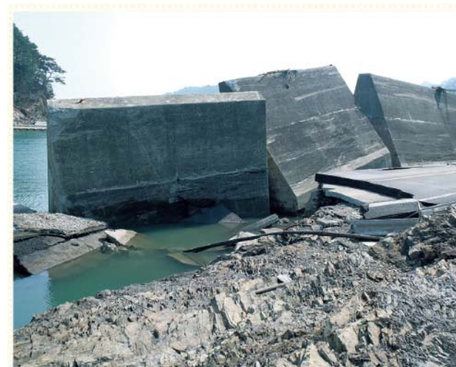
一般国道45号釜石市両石地区の道路流出(H23.3)
