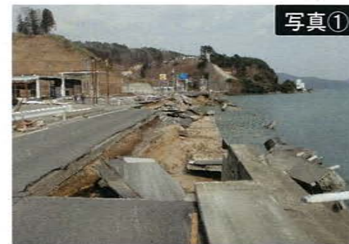
▼津波による国道45号の路面崩壊 (山田町)
