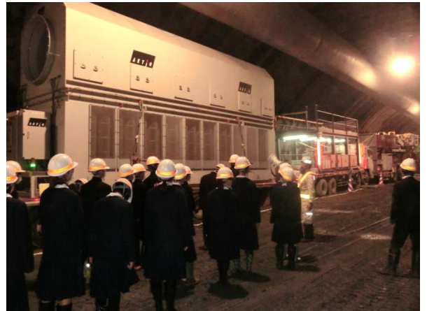
▲トンネル集塵機についての説明を受ける生徒の皆さん
