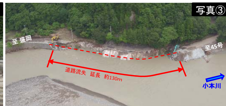
▼台風10号の被害状況 (国道455号)
