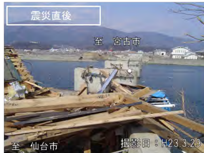
▲津波で流出した気仙大橋
