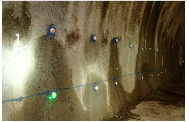
▲作成したボルトカバーはトンネル内に設置されました
