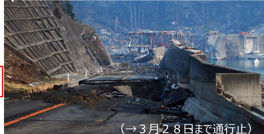
▼写真② 国道45号釜石市両石地区 (平成23年3月12日)
