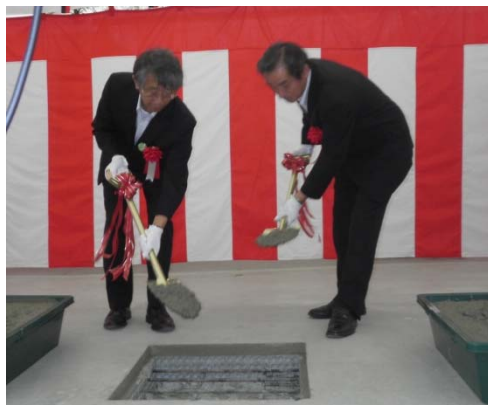
▲最終コンクリート打込み 三陸国道事務所長、普代村村長
