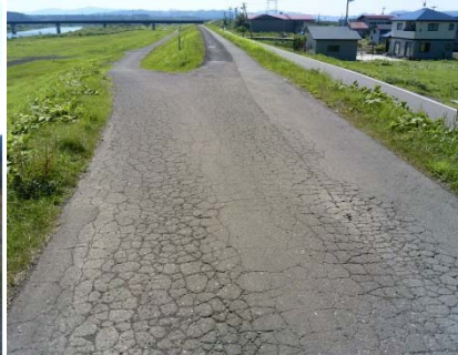
管理用通路の劣化状況
