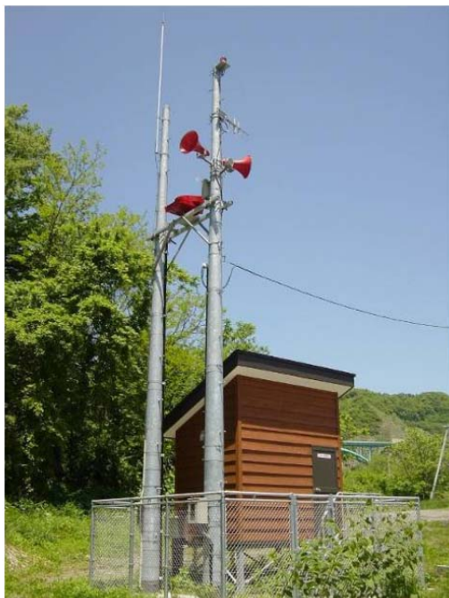
警報装置の状況
