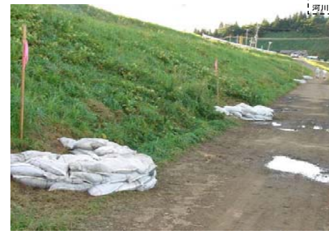
あままい 天内地区 堤防裏法面の漏水被害状況（H19.9洪水）
