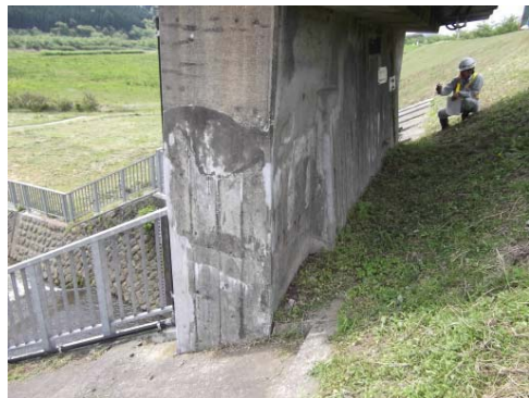
樋門門柱部の老朽化状況（監視・点検）
