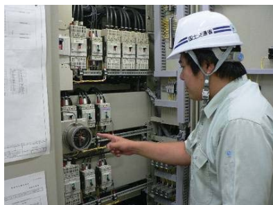
電気設備の点検状況
