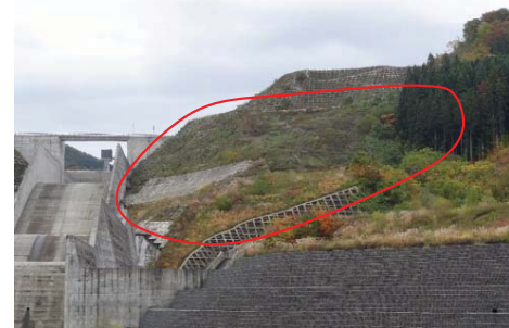
堤体左岸（洪水吐き付近）の地すべりブロック
