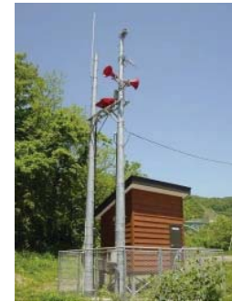
放流警報施設
