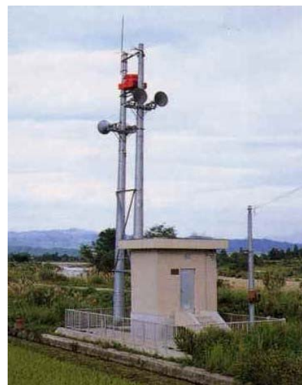
放流警報装置
