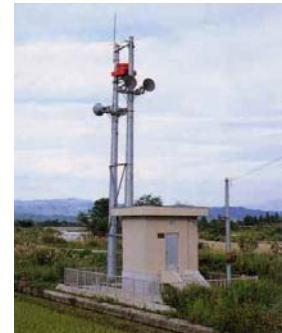
警報装置の状況
