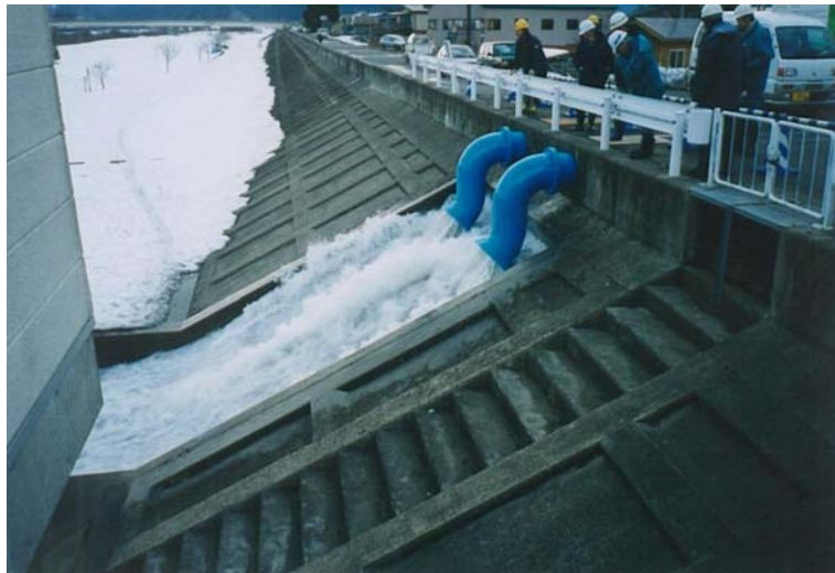
救急内水ポンプによる排除状況（能代市二ツ井町薄井地区）
