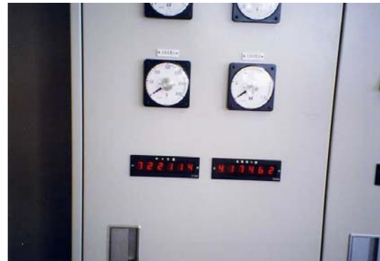
取水量計（能代市上水取水施設）
