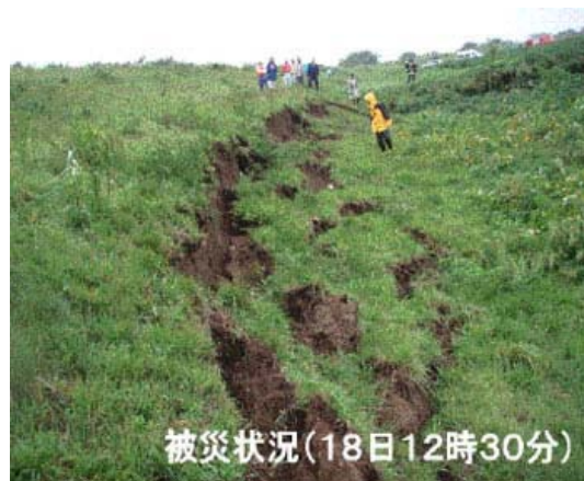
H19.9 洪水堤防被災状況 (能代市扇田地区)
