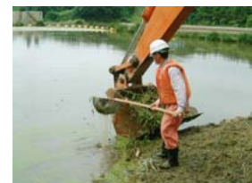
流木処理の状況
