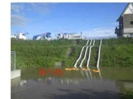
排水ポンプ車稼働状況
