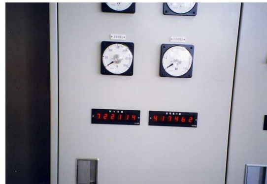
取水量計 (能代市上水取水施設)
