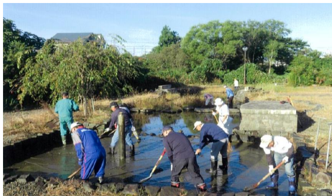
住民参加による河川管理施設の清掃（中川原自治会 桧山川運河浄化施設）
