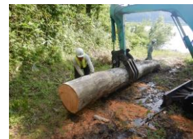
流木処理の状況
