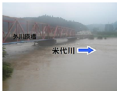
平成25年8月洪水による被災状況 (大館市早口 外川原橋付近)
