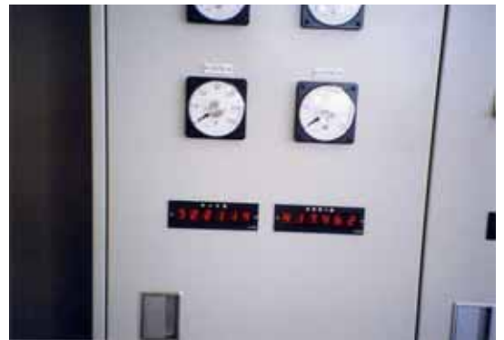
取水量計（能代市上水取水施設）
