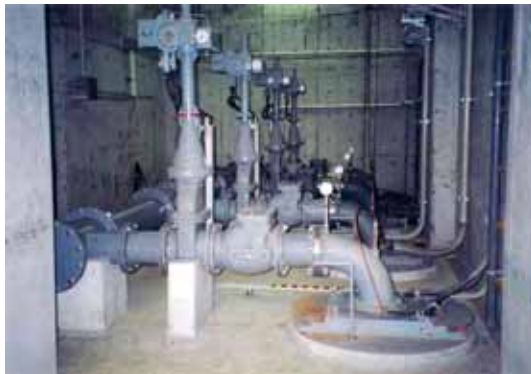
取水状況（能代市上水取水施設）
