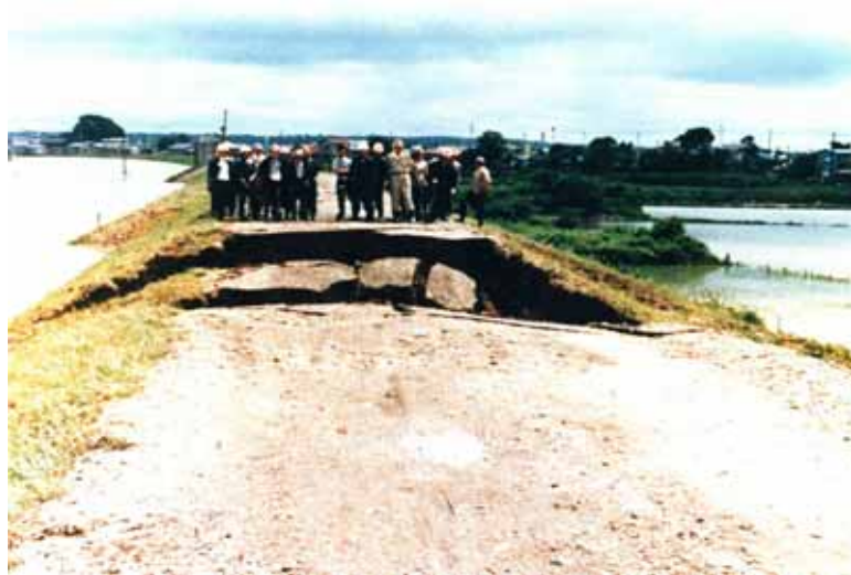
昭和47年7月洪水（能代市中川原地区破堤）
