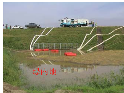
排水ポンプ車稼働状況
