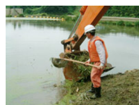
流木処理の状況
