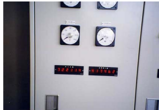
取水量計（能代市上水取水施設）
