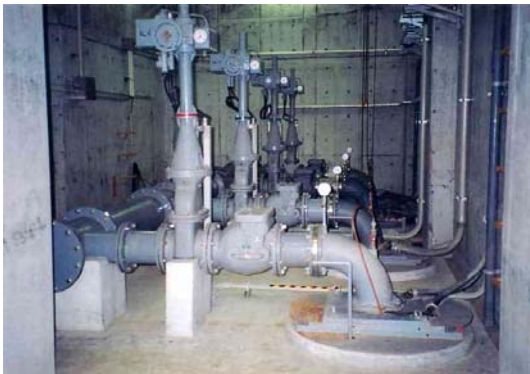
取水状況（能代市上水取水施設）
