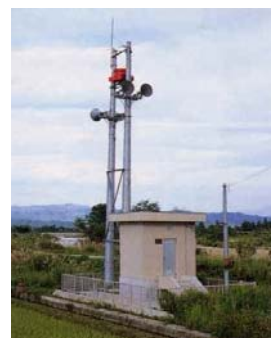
警報装置の状況
