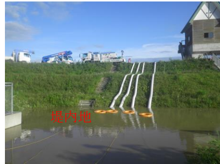
排水ポンプ車稼働状況
