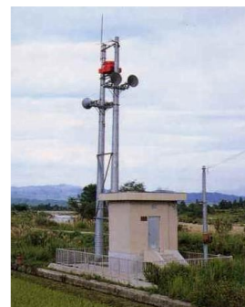
警報装置の状況
