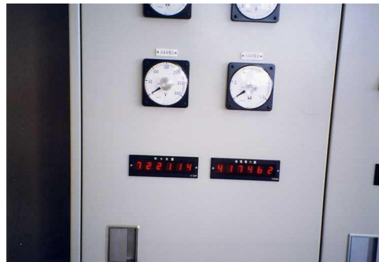
取水量計 (能代市上水取水施設)
