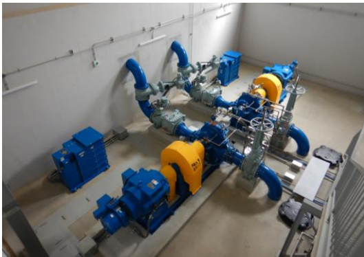
取水状況 (東雲開拓揚水機)
