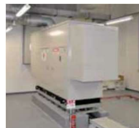
非常用発電設備のイメージ
