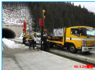
【小繋トンネル～今泉第一トンネル】 明り部中央分離帯防護柵設置着手
